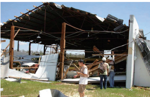
図 7. 強風による建物の被害調査
