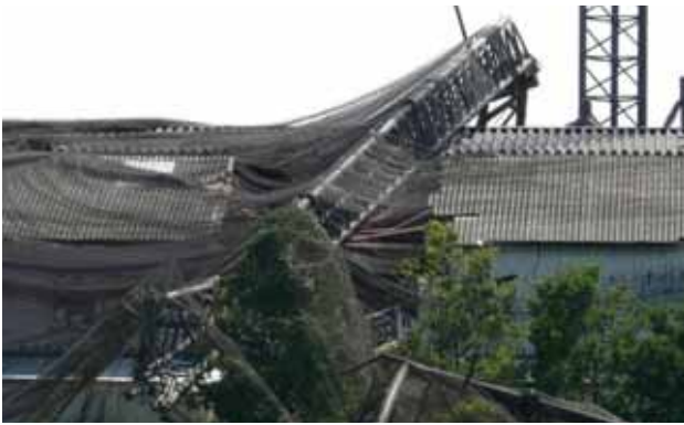
写真6 工場屋根の被害
