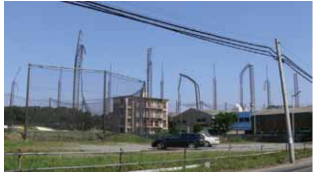
写真3 ゴルフ場ネットを支える鉄塔の被害
