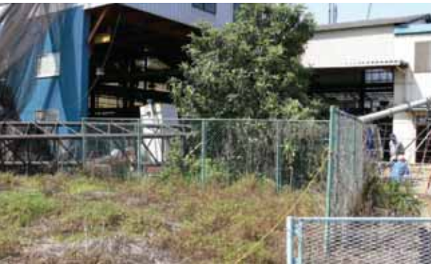
写真7 倒壊した鉄塔により電柱が倒壊した
