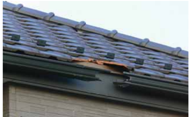
写真9 飛来物による屋根葺材の被害
