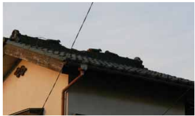
写真10 屋根棟瓦の被害
