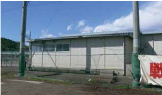
写真1 運動場倉庫の庇の損傷
