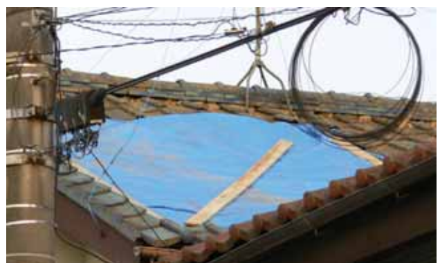
写真11 屋根葺材の被害
