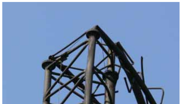
写真4 鉄塔の折損箇所
