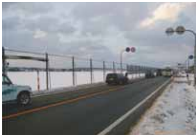
地点2 広栄町における防雪柵の被害
