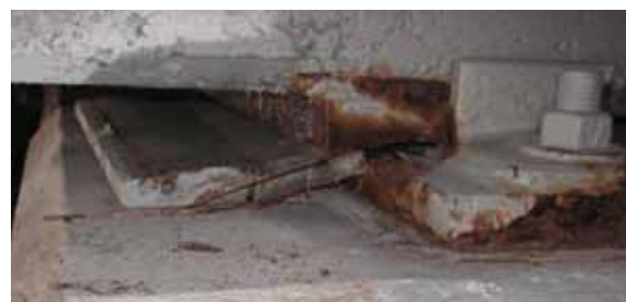
写真 15 支承のライナーの抜け出し
