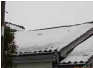
地点3 榎木地区における棟瓦の被害
