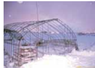
地点4 石名坂地区におけるビニルハウスの被害
