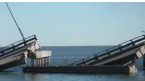
写真 14 Biloxi の PC 橋の被害
