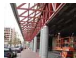
写真 8 軒天井とキャノピー被害
