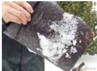
同 棟瓦は一続きに針金で結束されていた
