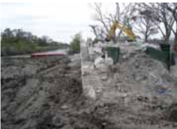
写真 11 運河堤防決壊箇所
