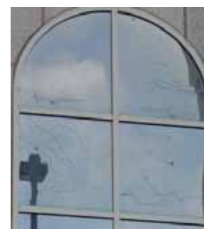
写真 4 窓ガラス被害例
