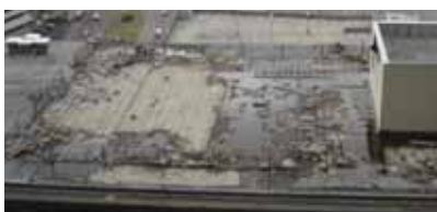
写真 5 ビル屋上のスレート材の飛散
