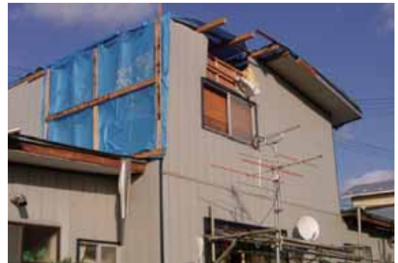
地点6 琴丘町内の被害。壁面，屋根に損傷を受けている。
